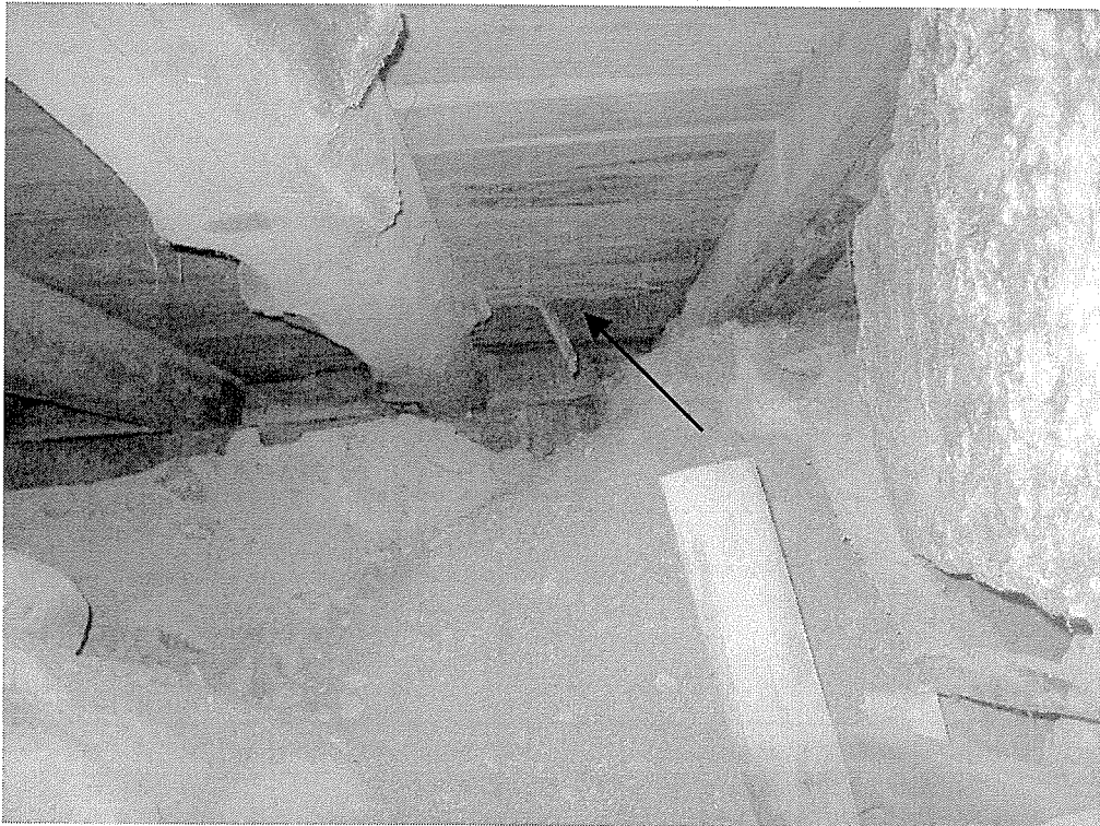
Kuva 8. Alapohjan kannatinlauta kuvan mukaan näyttää pehmenneeltä (nuoli). Kuvan osoittamaan nurkkaukseen ei pääsyä.
