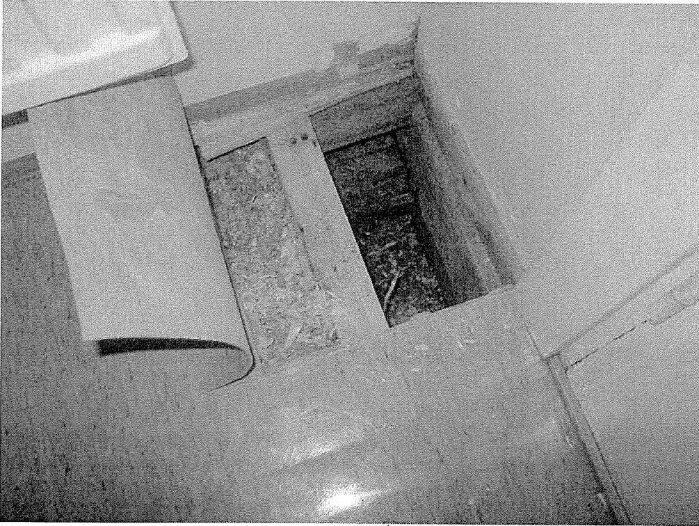
Kuva 1. Lattiarakenne. Puurakenteessa lahovauriota. Opetustila 3.
