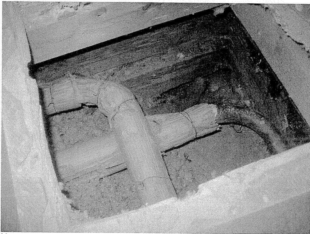
Kuva 2. Lattiarakenteita. Puurakenteessa lahovauriota.
