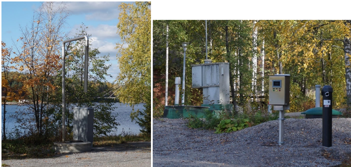
Kuva. Palomäenkadun päässä sijaitseva vesipiste ja pumppaamo.
