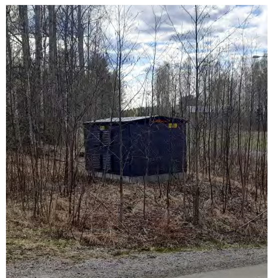
Kuva 25. Koivistonkyläntien ja koulun liittymän vierellä on sähkömuuntaja.
