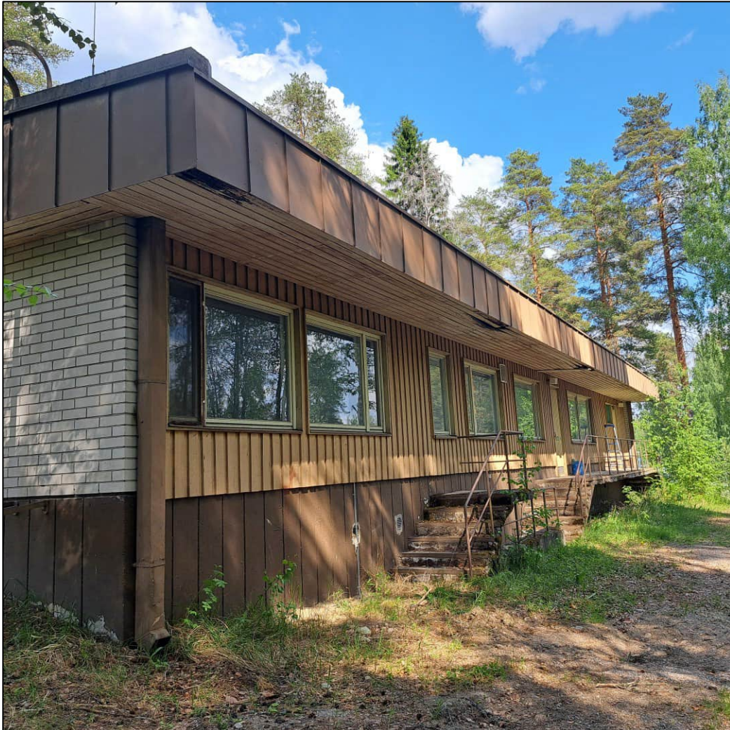
Kuva 74. Vanhan työterveystalon (kohde 7.1) eteläseinustaa talon lounaisnurkalta kuvattuna. Luhtikäytävän lattialta löytyi hiukan yli 15 lepakon papanaa toukokuun 2024 lopun käynnillä kuvan oikeassa reunassa näkyvien harmaasinisten porrastikkaiden kohdalta ja elokuun 2024 lopun käynniltä samasta paikasta n. 20 papanaa. Välikaton alapohja on niin laho, että lahous näkyy kuvassakin selvästi. Kuvaussuunta itäkoillinen.
