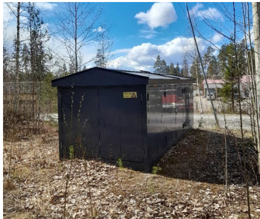
Kuva 21. Kuvassa KTY-tontille sijoittuva jätevedenpumppaamo.
