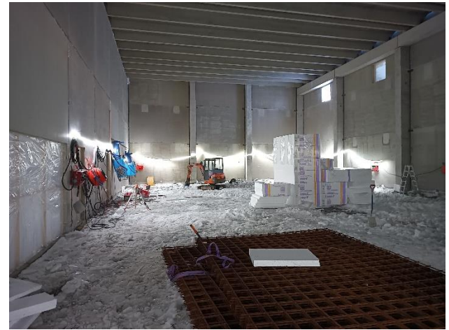
1.krs, lohkon 1 liikuntasalin lämmitykset/sähköistyksset /valaistukset.
