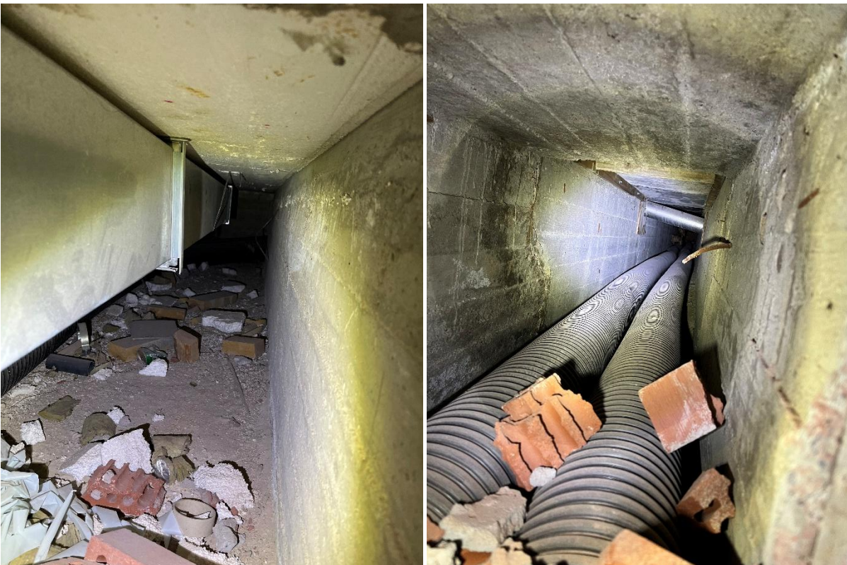
Vanhoissa putkikanaaleissa jätetty edellisissä remonteissa hyvin paljon muotteja rakenteisiin.
