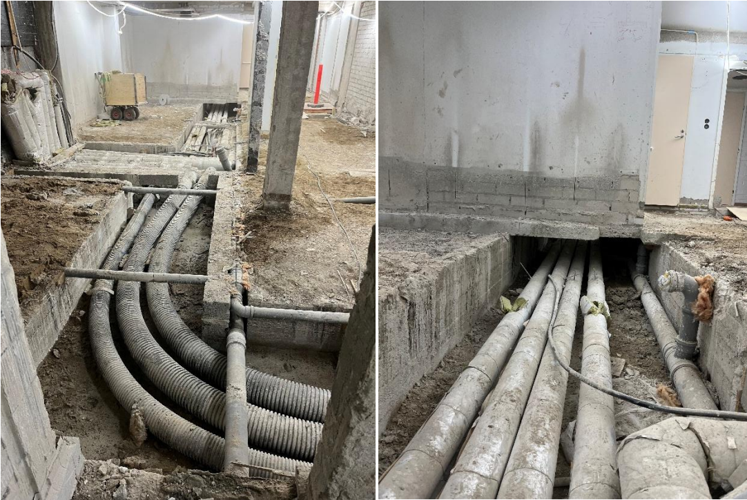
Putkikanaalit naisten pesuhuoneen lattian alla hidastaneet rakennustöitä. Vanhat seinät rakennettu kanaalin päälle.
